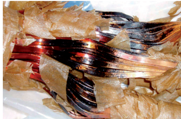
Imagen 1. Efecto del Sulfuro de Cobre ( Cu_2S ) en los devanados.
